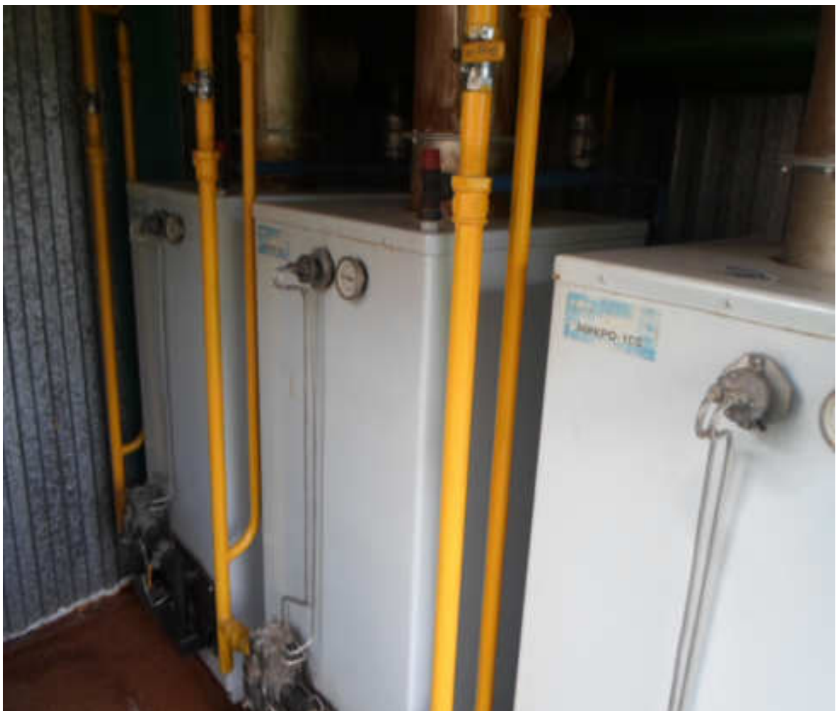
Видимое изображение №3 Трубопроводы обвязки котлоагрегатов
